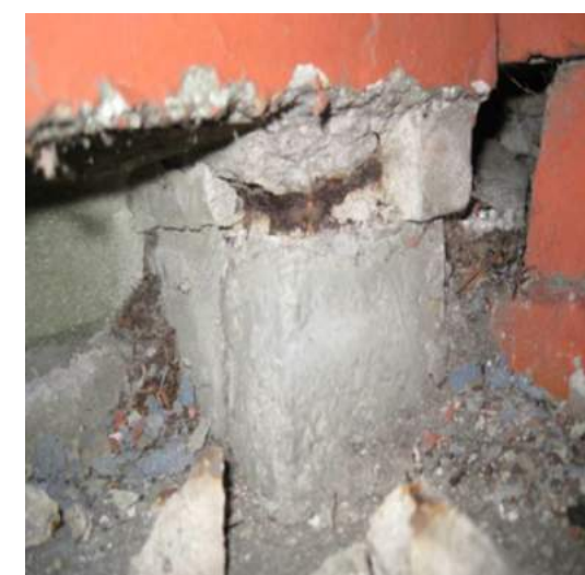
Altan: Indstøbt montagebolt/beslag er korroderet og har sprængt betonen af.
