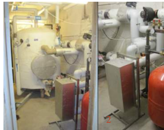
Varmtvandsbeholderen fra 1999 (2000 liter)
