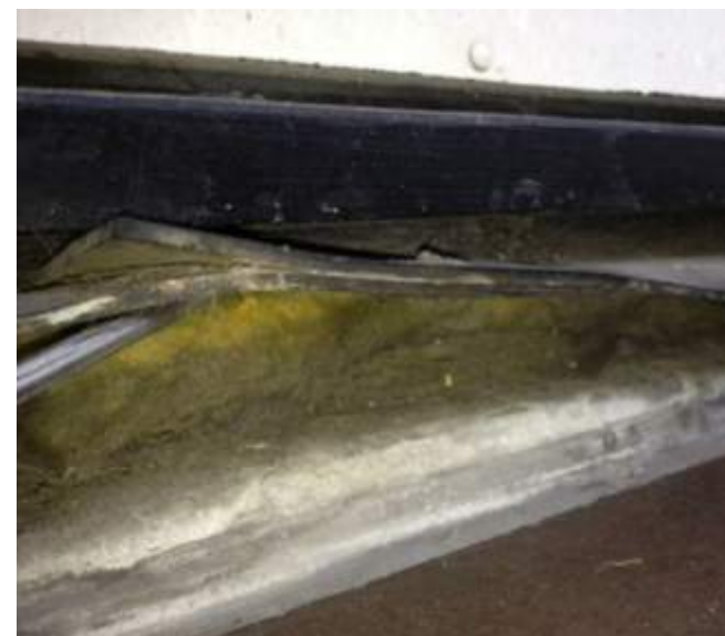
Mangelfuld inddækning ved vindueselementets underside. Inddækning indeholder PCB.
