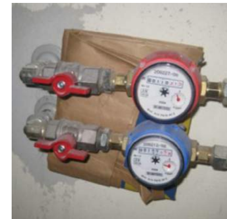
Pladeveksleren fra 2008 i varmecentralen
