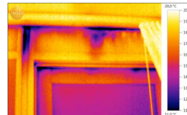
Termografibilleder af træk fra vindue.
