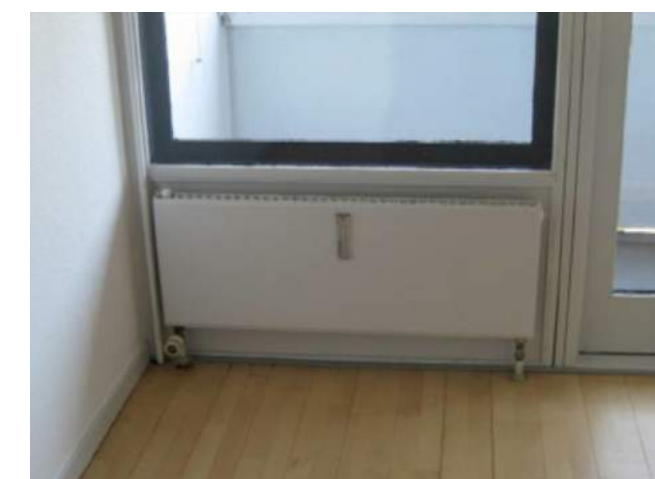
Typisk radiator, med ældre termostatventil og fordampningsmåler.
